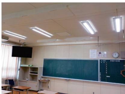
▲LED化された中学校教室の照明
