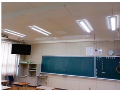
▲LED化された中学校教室の照明
