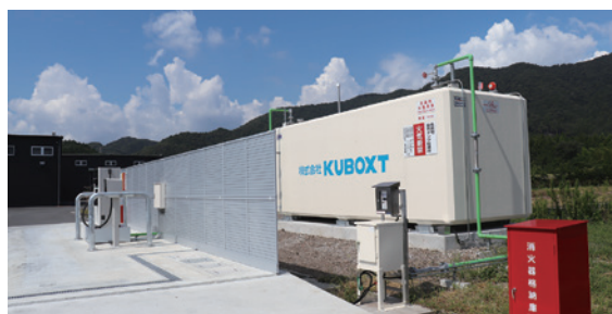
▲燃料(軽油)を貯蔵する「コンボルト型タンク」
