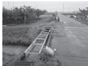
▲水路に刈草等が詰まっている様子
