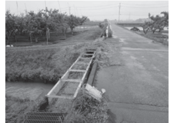
▲水路に刈草等が詰まっている様子
