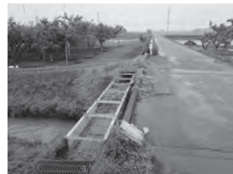
▲水路に刈草等が詰まっている様子
