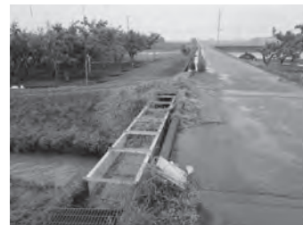
▲水路に刈草等が詰まっている様子
