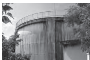
▲大野配水池／古川地内
