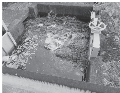
水路にごみが詰まった様子
