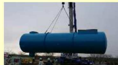
飲料水兼用耐震性貯水槽
