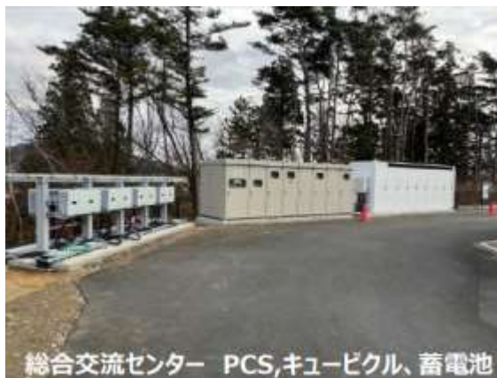
図4-26 蓄電設備 (環境省 事例集)
